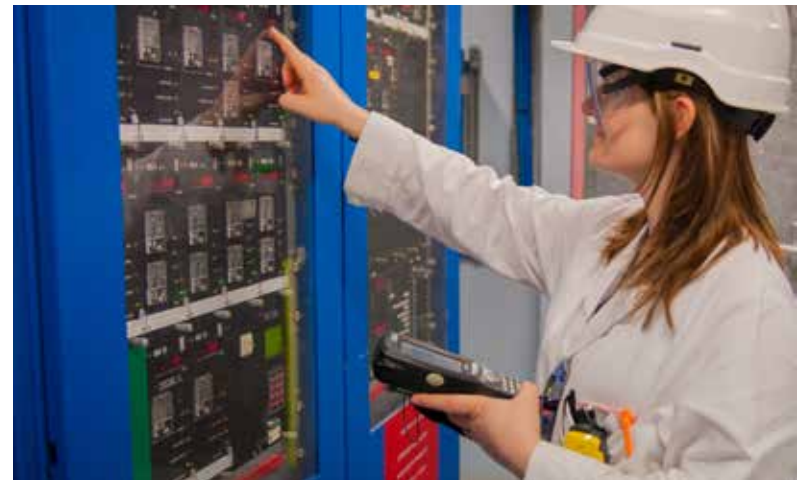
Relevé de paramètres dans les locaux électriques Blayais
