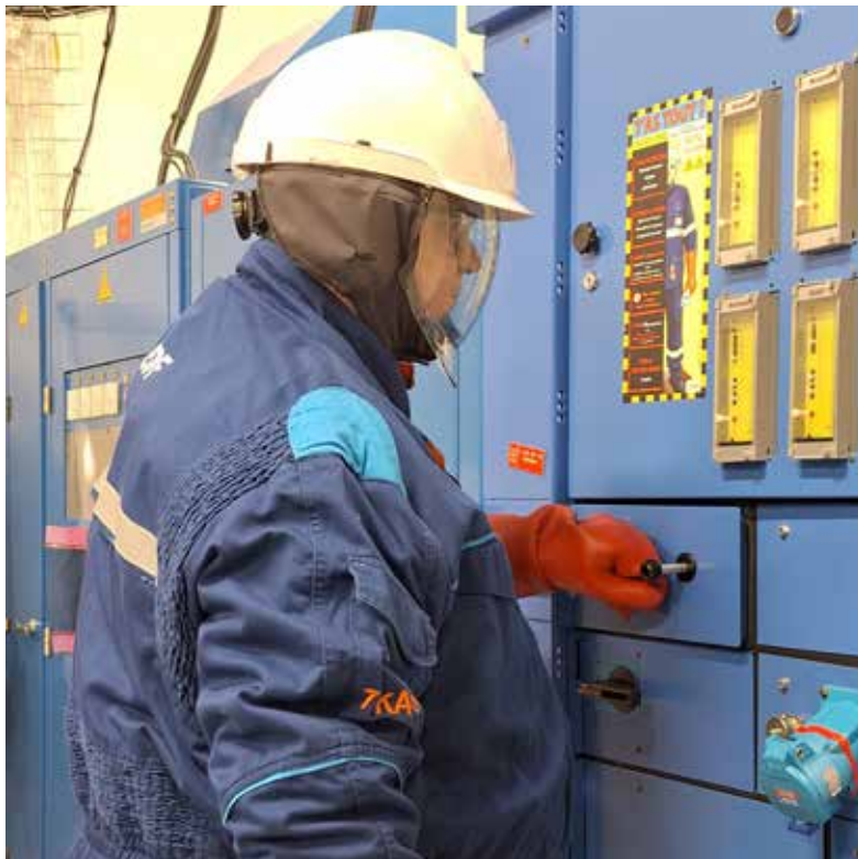
Manœuvre de cellule électrique Saint-Laurent-des-Eaux B
