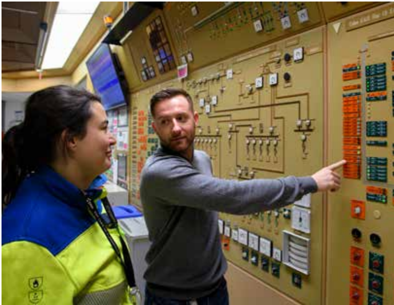
Salle de commande Flamanville 1&amp;2
