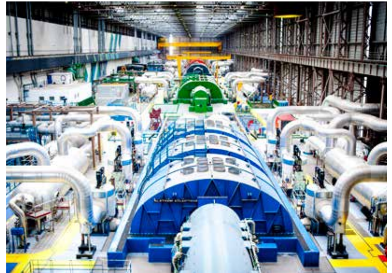
Salle des machines Tricastin
