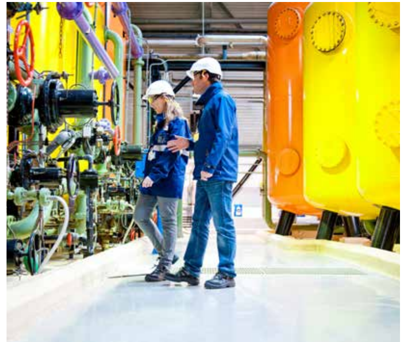
Techniciens devant les osmoseurs Tricastin
