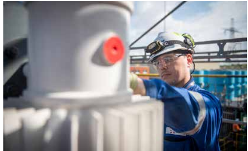
Inspection d'un transformateur Heysham 2
